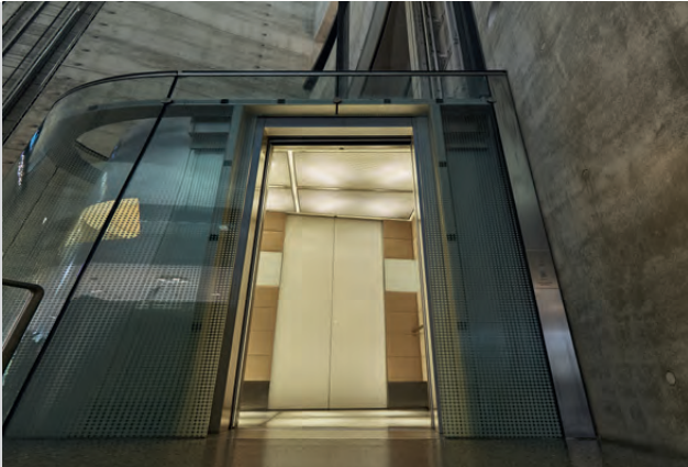
Aufzugsbau Lift fittings
